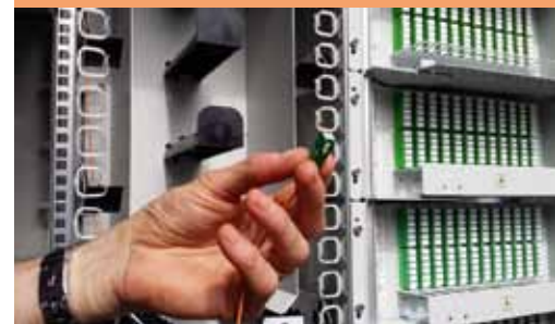
Raccordement d'un client dans une armoire optique.
